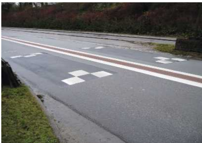
Vejreglen for asfaltbump indeholder nogle problematiske områder i relation til tolerancer for udførelsen af asfaltbump og mangelsvarsperioden for sporkøring af asfaltbump.
