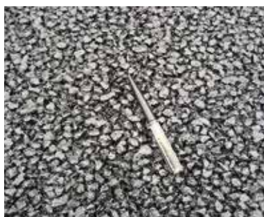
Projekt Klimavejen tager udgangspunkt i NCC A/S Roads udviklingsarbejde inden for permeable belægninger. Her ses en forsøgsudlægning med drænasfalt på Lufthavnsvej i Nørresundby. Foto: NCC Roads A/S.
