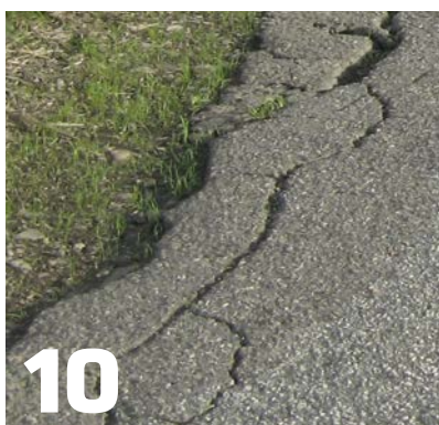
Det er på tide at få løst problemet med tunge gyllekøretøjers slid på små og svage veje.
