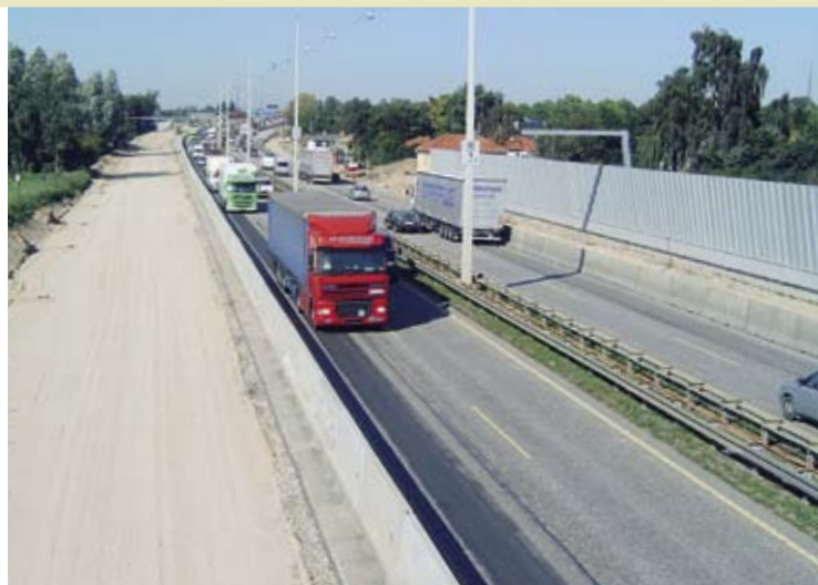
På strækningen igennem Herlev er man kommet langt med sideudvidelsen og opsætningen af støjskærme med en typisk højde på 4 meter over vejniveau.
