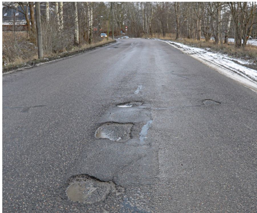
De lange vinterperioder med omskifteligt vejr slider hårdt på både asfalten og vej-kassen nedenunder.
