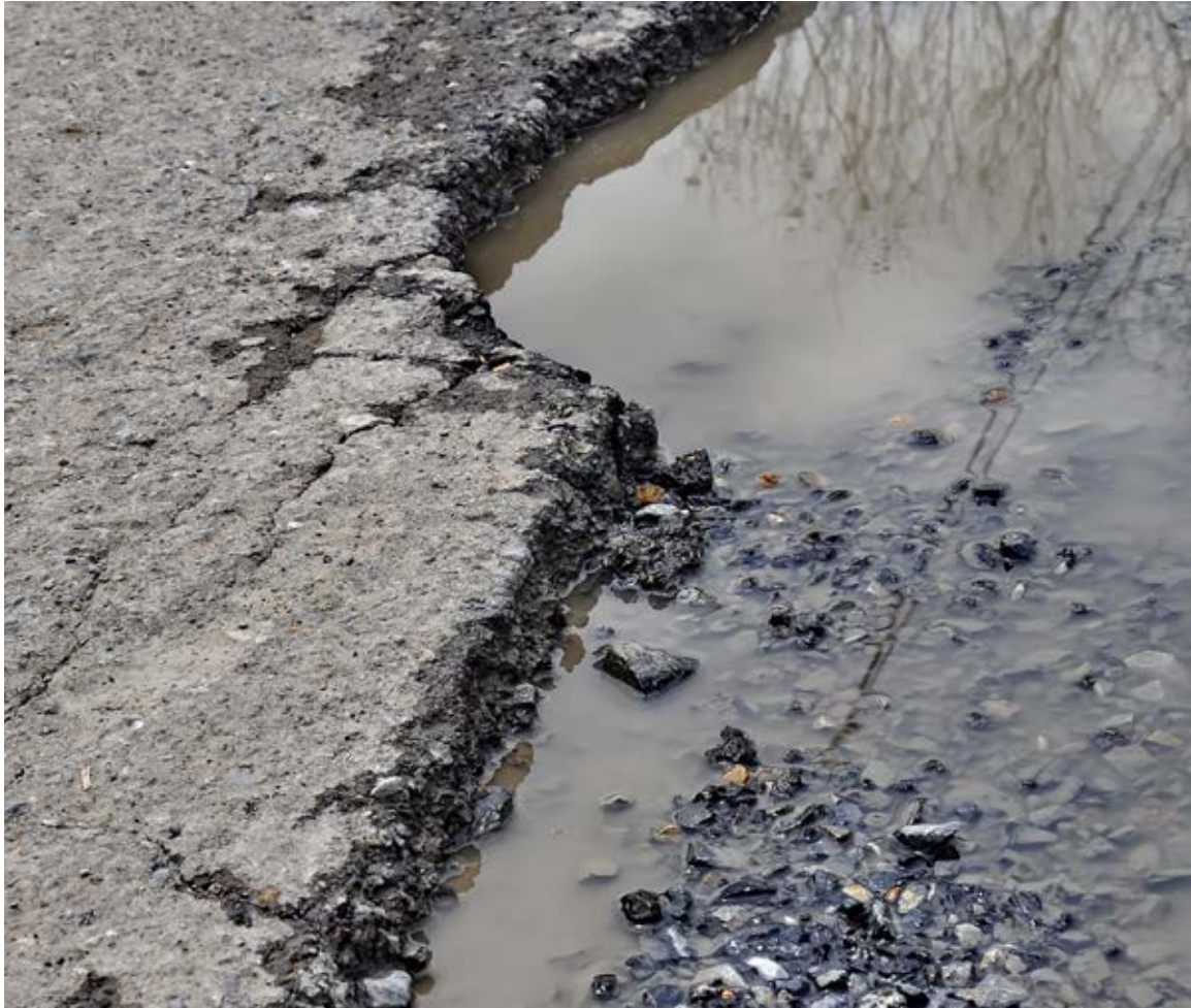
Vej, der kræver vedligeholdelse
