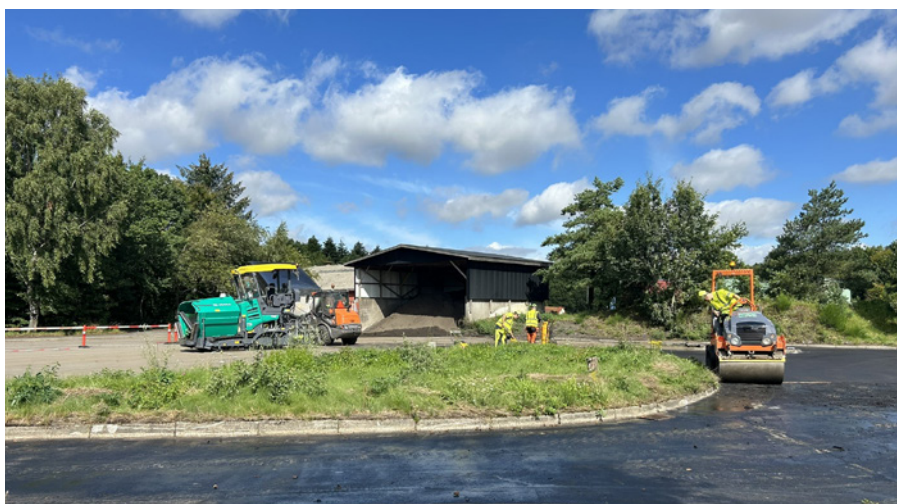
På det nye prøveareal skal lærlingene bl.a. demonstrere, at de kan deres håndværk, når der skal lægges asfalt i et stykke af en rundkørsel, hvor vejen buer. De skal også lave korrekt fald ved brønde og riste.
